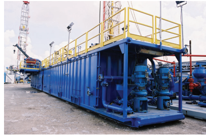
Estación de mezclado de lodo
