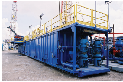
Station de mélange de boue
